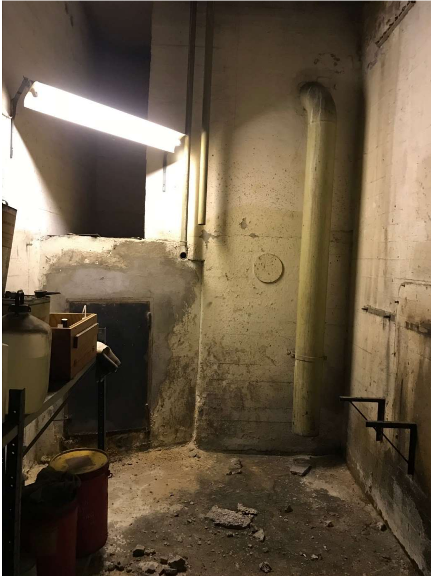
Figur 14. Pannrum i källarvåning.
