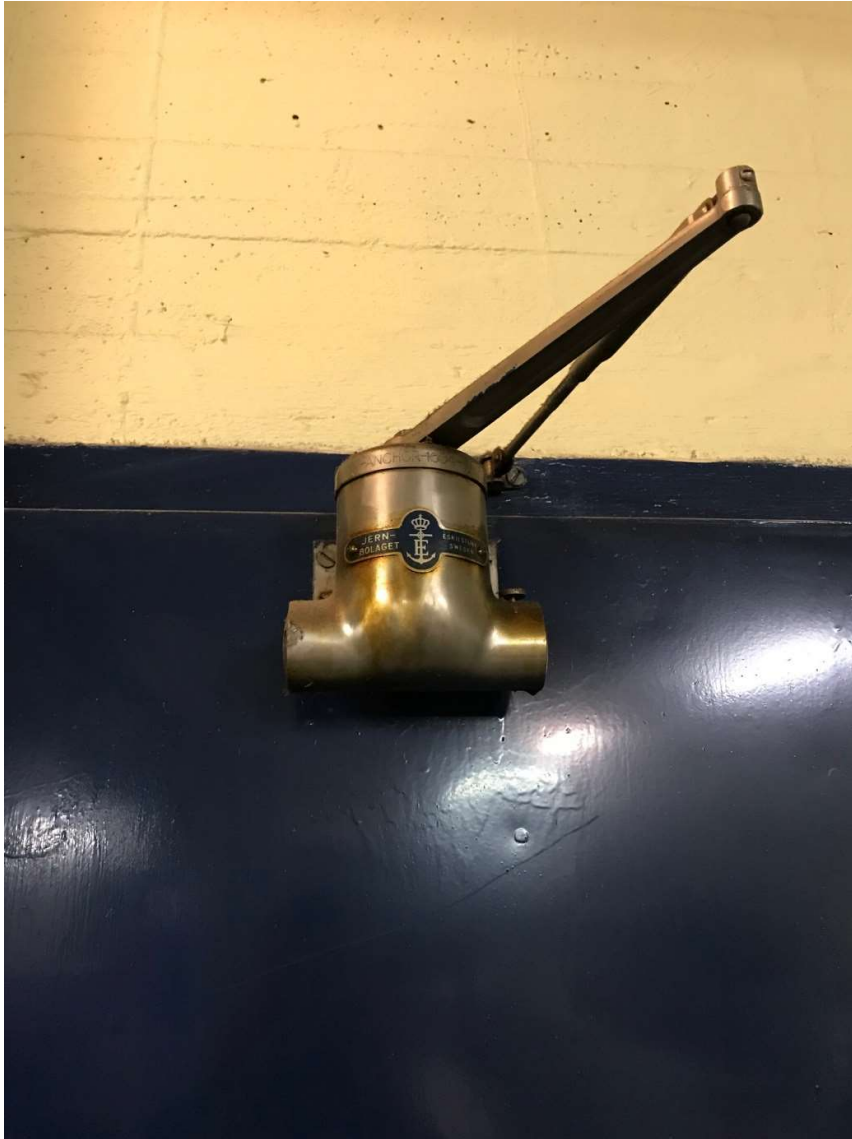
Figur 15. Dörrstängare innehållande PCB.
