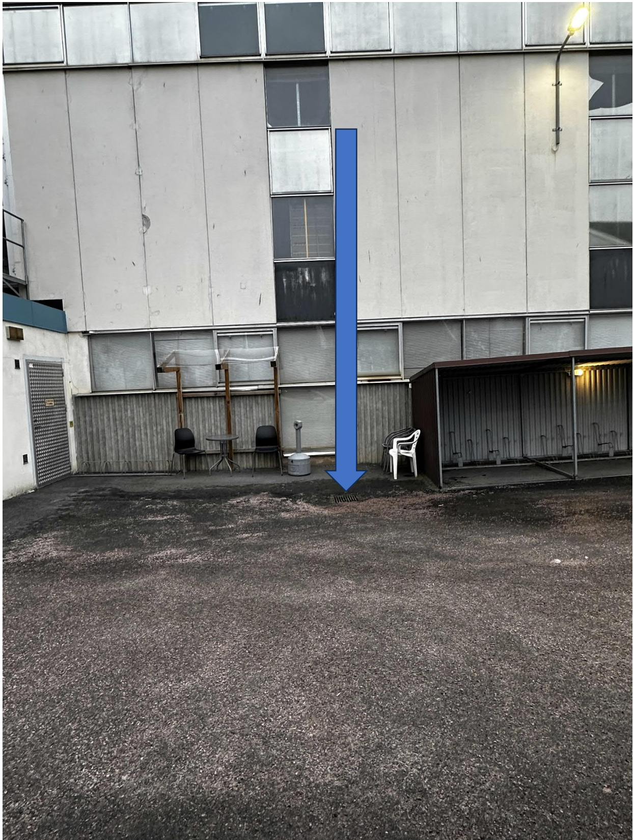
Foto visar asfaltytans lågpunkt. Pilen pekar på rännstensbrunn.
