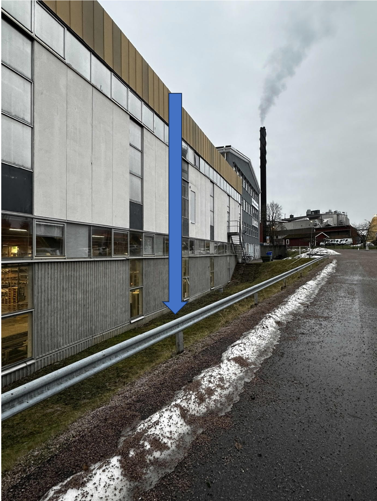
Foto visar lågpunkt som saknar avvattningsanordning.
