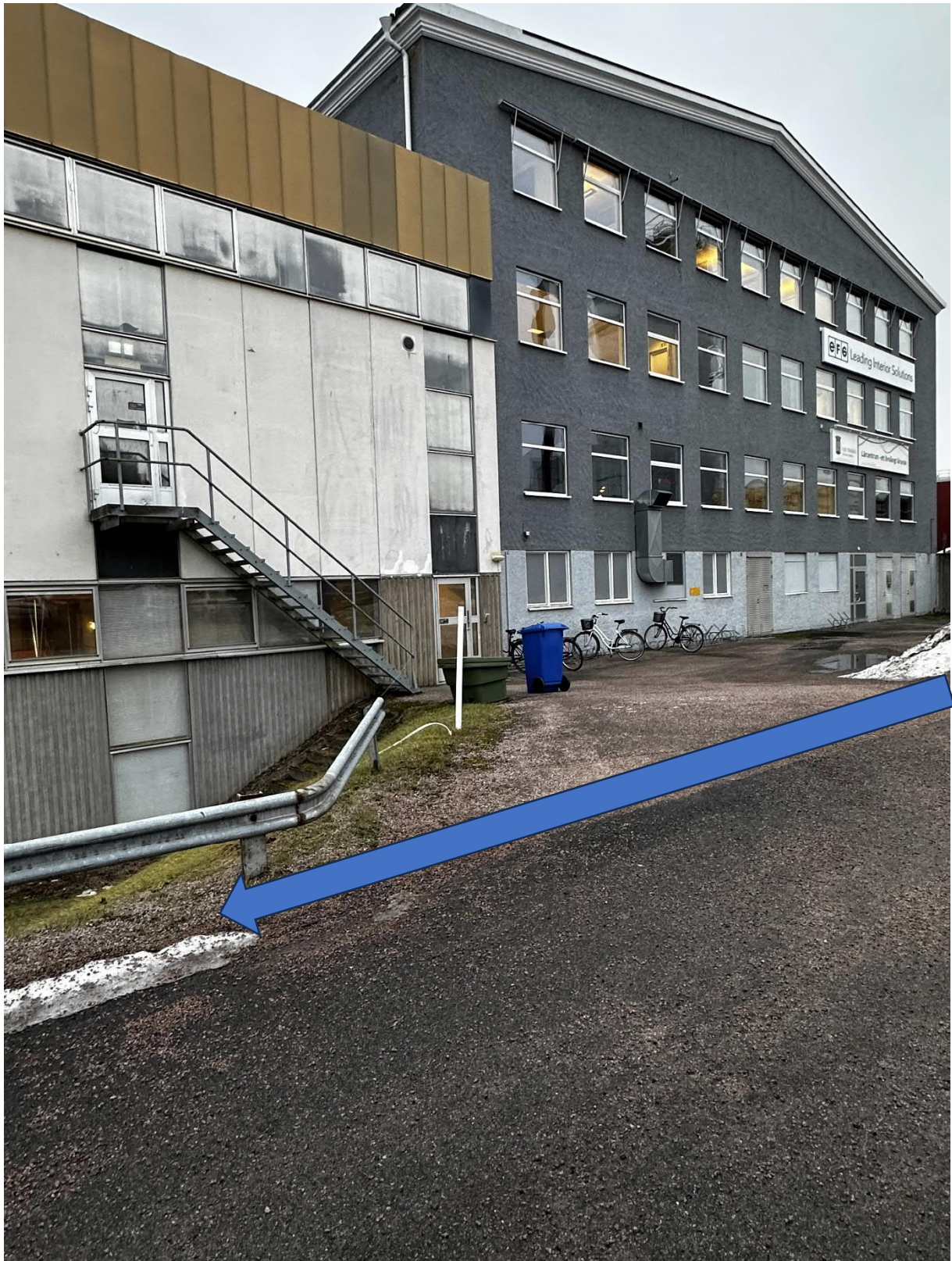
Foto visar nedfart mot byggnad som bör förses med kantsten. Pil visar lämplig placering av kantsten.
