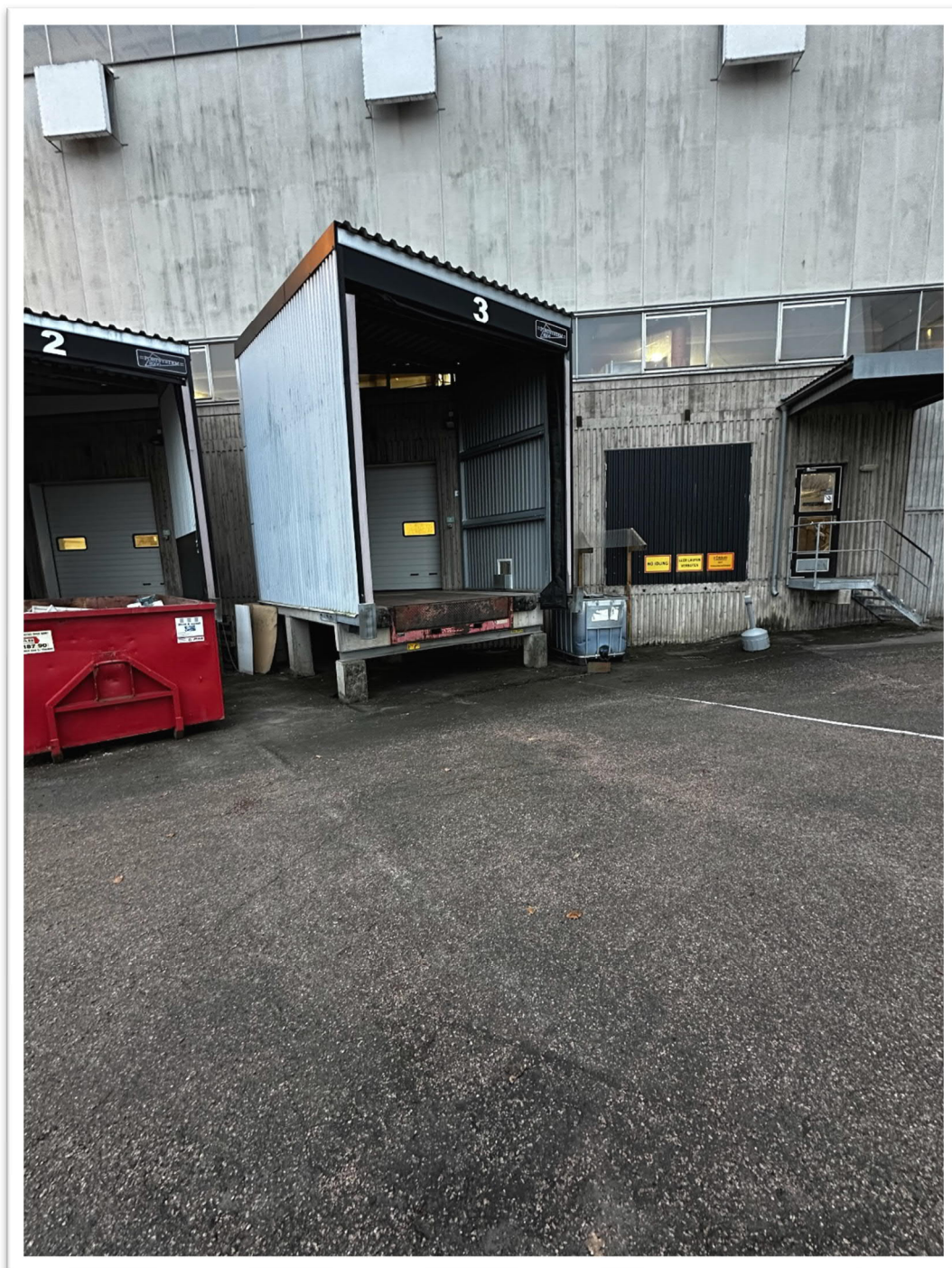
Figur: Lågpunkt vid byggnadens norra sida.
